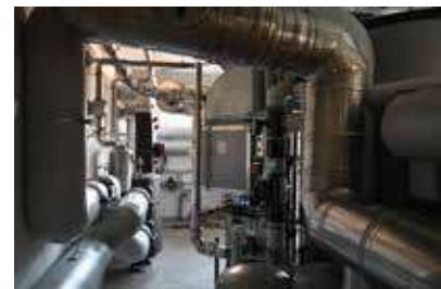
Blick in die Heizzentrale
